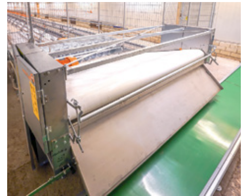
糞は床面レベルの横送りベルトへ 移送されます
